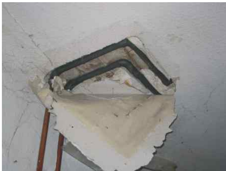
Schadhafte Stelle Decke 1.OG in nicht vermietetem Zimmer
