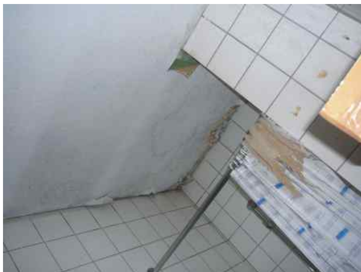
Schadhafte Decke in Bad
